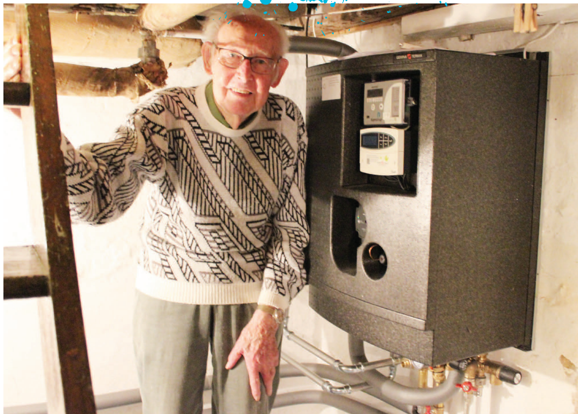
Med den nye fjernvarmeveksler slipper Niels Graversen for mange ture i kælderen for at skrue på varmeanlægget.
